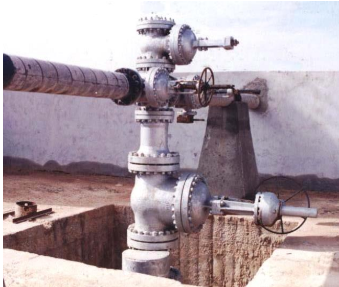
Figure 4 : Tête d'un forage du Continental Intercalaire à Zaouiet Riab, Djamaa 1 .
