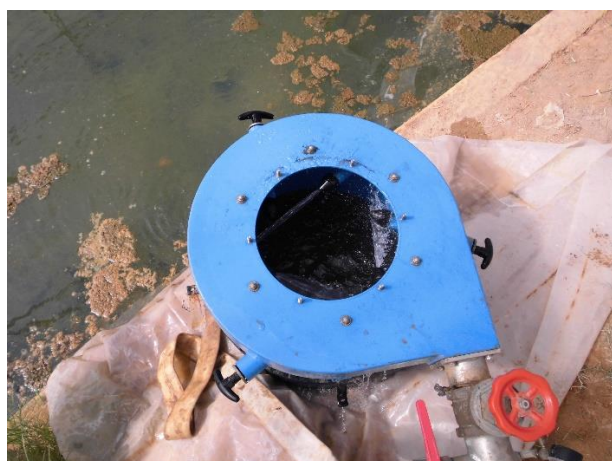
A- Très faible jet d'eau au niveau des injecteurs du bloc de distribution
