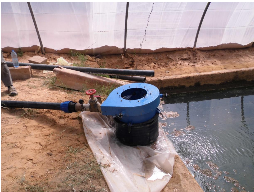
Figure 38 : Cadre général de l'essai de la microcentrale au niveau de la ferme pilote de Hassi Benabdallah - Wilaya de Ouargla (fin Mars, 2013)
